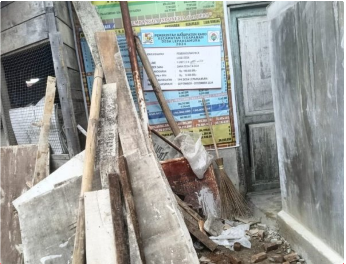
Potret Bangunan Fasilitas MCK Desa Lepar Samura yang Telan Dana Ratusan Juta
